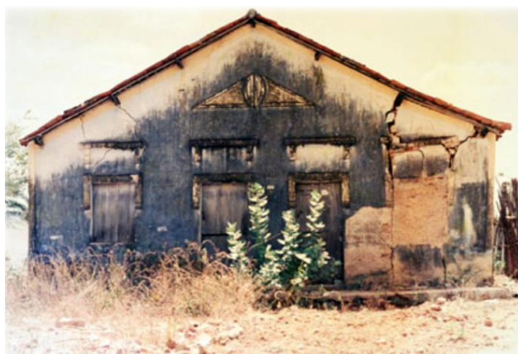
Figura 29 - Fazenda Tapera em ruínas
