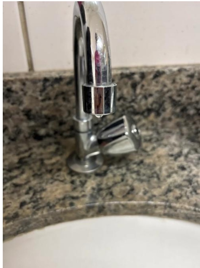
Figura 12– Gotejamento esporádico em torneira no Bloco F - Térreo - Banheiro feminino
