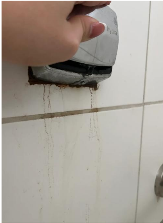
Figura 22- Vazamento na Quadra 1 - Térreo - Banheiro masculino
