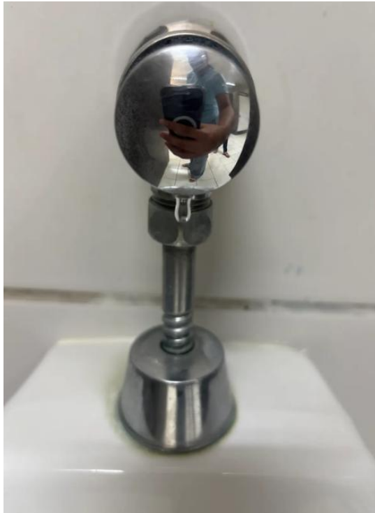
Figura 29 – Vazamento no acionador do mictório Bloco C - Térreo - Banheiro masculino
