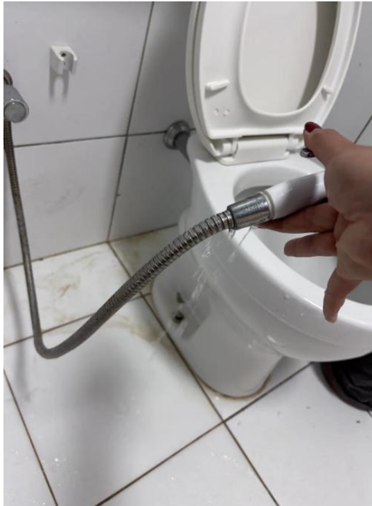
Figura 34– Vazamento em ducha Bloco N - Térreo - Banheiro acessível masculino
