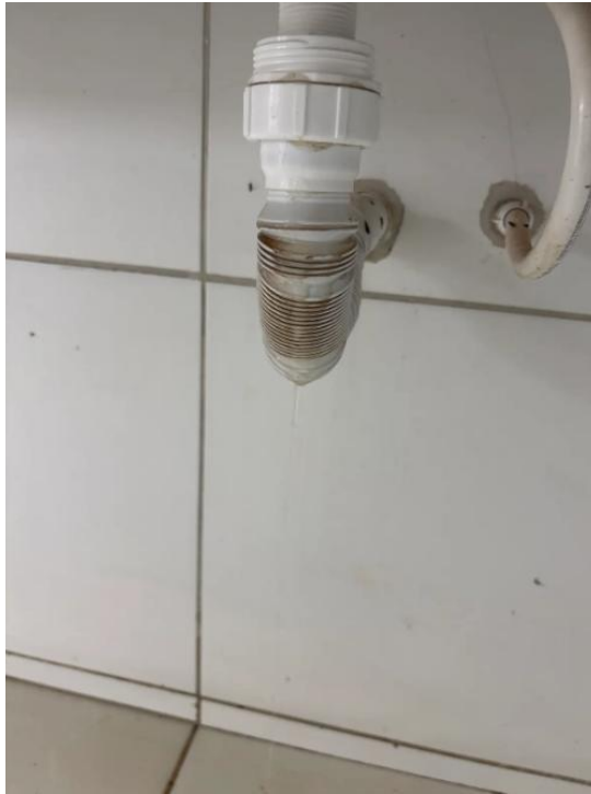
Figura 13 - Vazamento no sifão da torneira Quadra 2 - Térreo - Banheiro feminino
