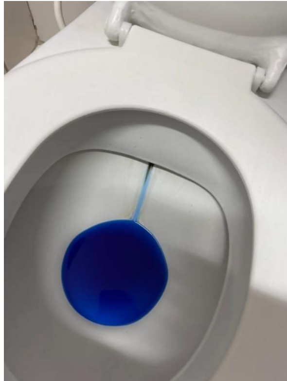
Figura 24 - Vazamento no Bloco E - Térreo - Banheiro feminino
