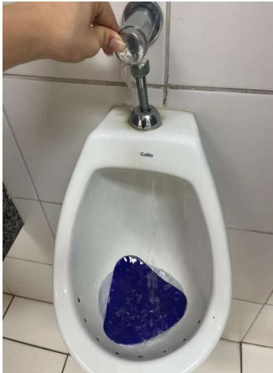
Figura 26 – Vazamento em acionamento de mictório Bloco C - Térreo - Banheiro masculino
