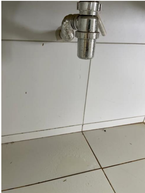
Figura 14 - Vazamento no sifão da torneira Quadra 2 - Térreo - Banheiro feminino
