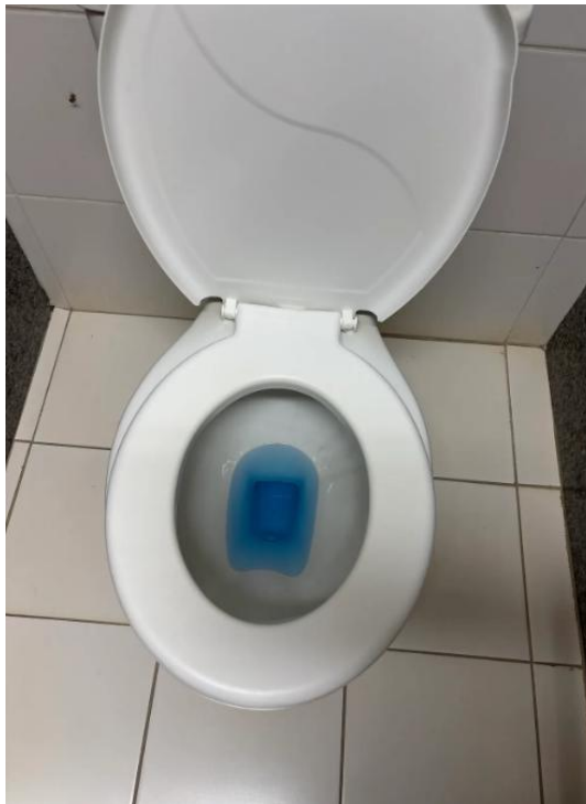
Figura 23 – Vazamento no Bloco C - Térreo - Banheiro masculino
