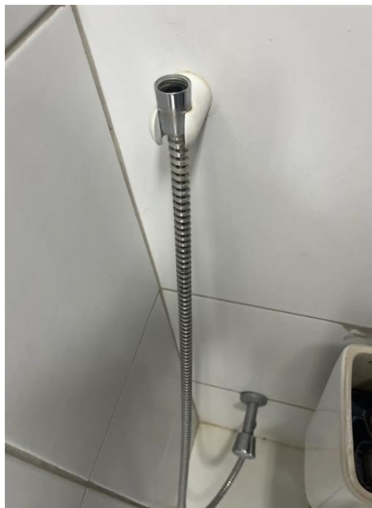
Figura 31 – Ducha quebrada Bloco I - Subsolo - Banheiro feminino
