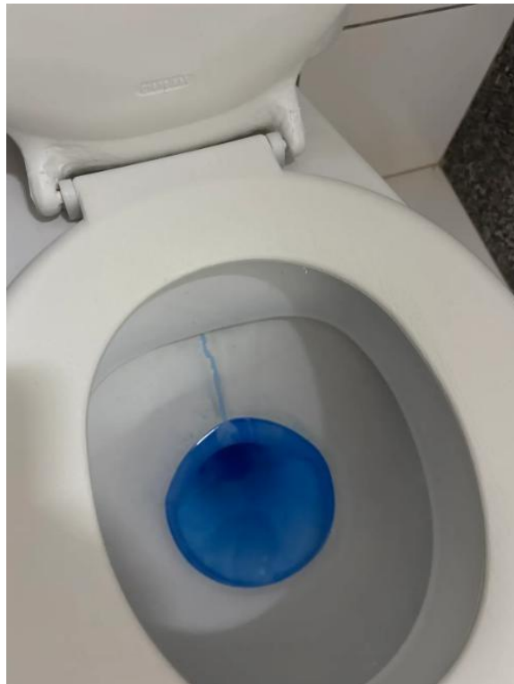
Figura 21 - Vazamento no Bloco E - Térreo - Banheiro feminino
