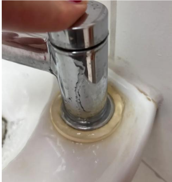
Figura 15 - Vazamento no corpo da torneira - Bloco F - Térreo - Banheiro acessível feminino
