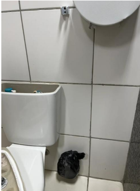
Figura 32 – Ducha quebrada Bloco K - Subsolo - Banheiro masculino
