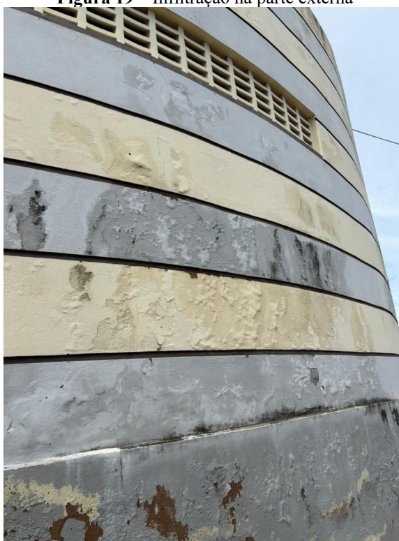
Figura 19 – Infiltração na parte externa
