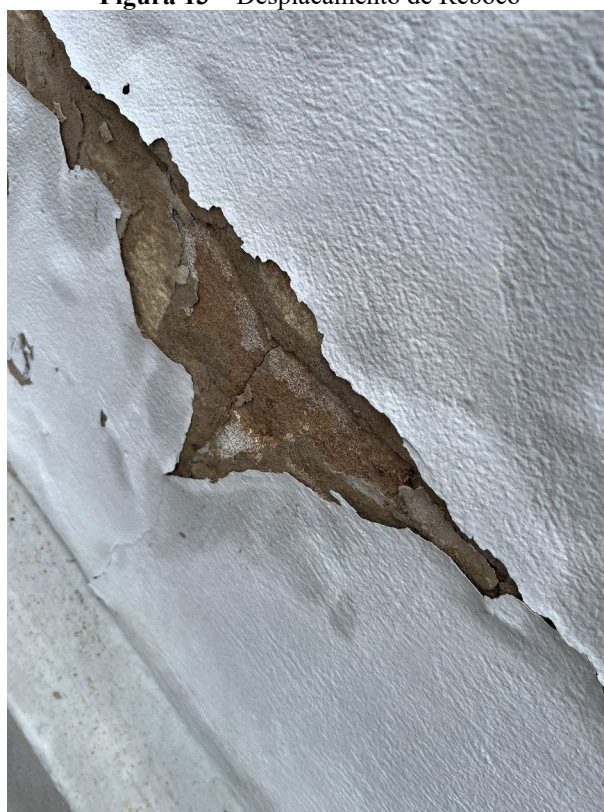
Figura 13 – Desplacamento de Reboco
