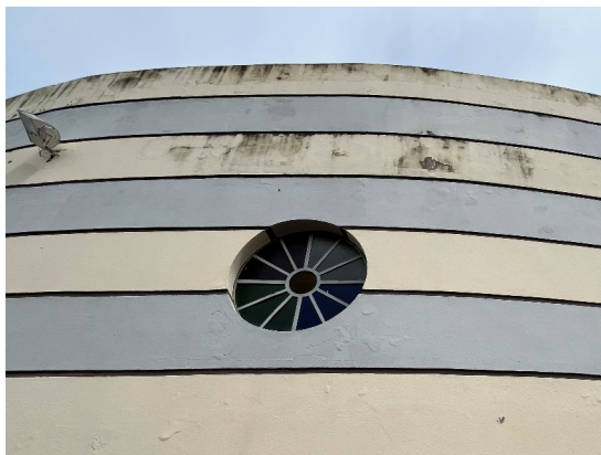
Figura 16 – Fissuração devido à possível falta de contraverga
