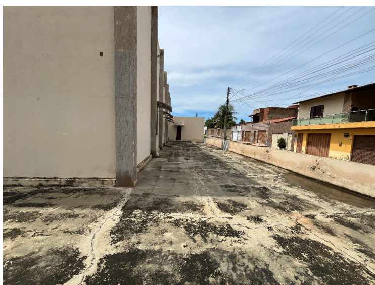
Figura 28 – Fissuração ao longo do Átrio
