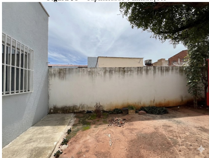
Figura 31 – Capilaridade e Infiltrações
