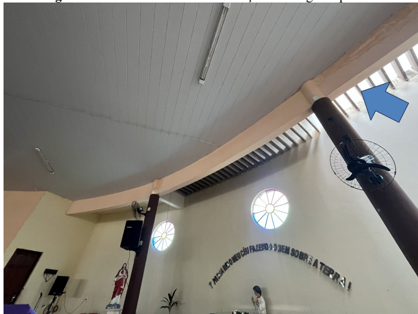
Figura 10 – Parte interna com infiltrações nas vigas superiores
