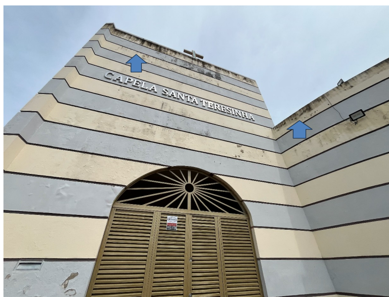
Figura 14 – Manifestação de sujidades na fachada devido às intemperes da Capela de Santa Teresinha
