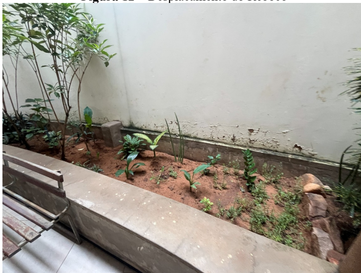
Figura 12 – Desplacamento do Reboco
