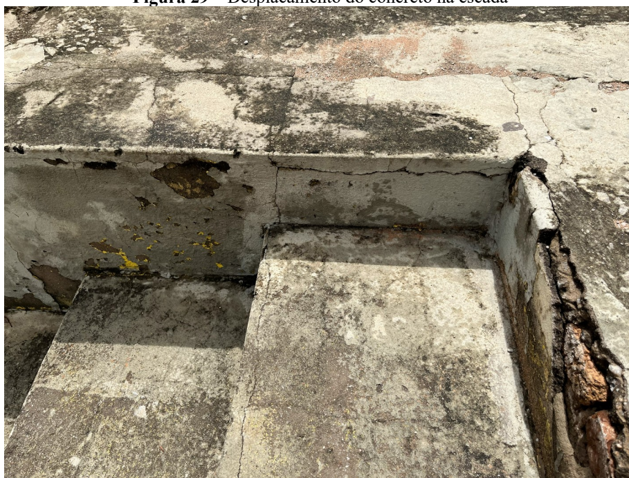
Figura 29 – Deslocamento do concreto na escada
