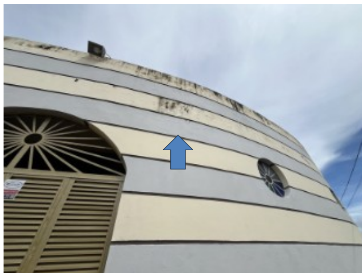
Figura 15 – Manifestação de sujidades na fachada devido às intemperes da Capela de Santa Teresinha
