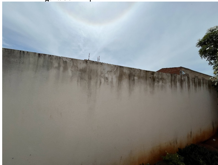
Figura 30 – Capilaridade no Muro de divisa
