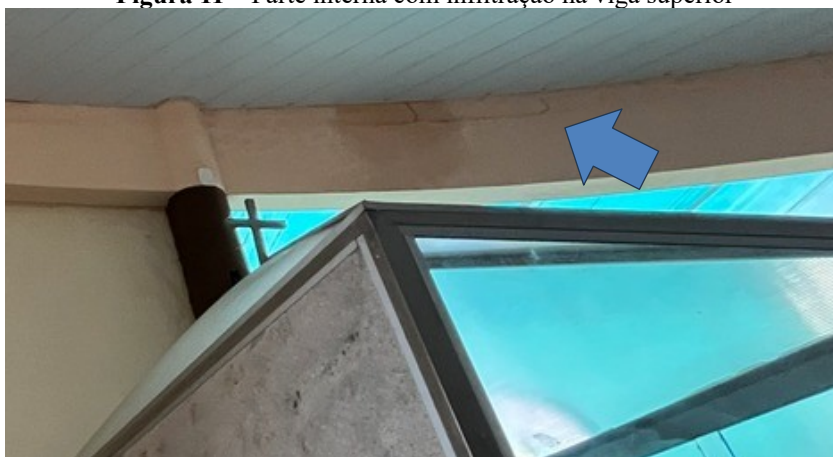
Figura 11 – Parte interna com infiltração na viga superior
