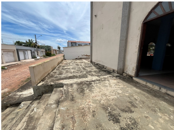
Figura 27 – Fissuração ao longo da calçada do Átrio
