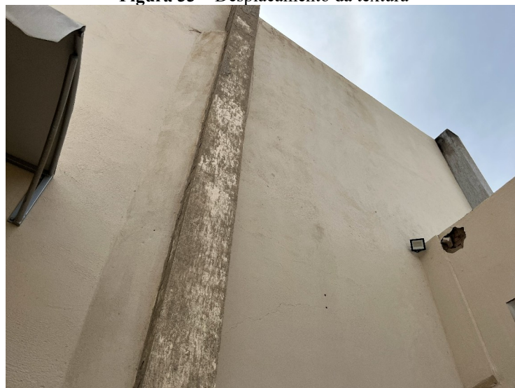
Figura 33 – Desplacamento da textura
