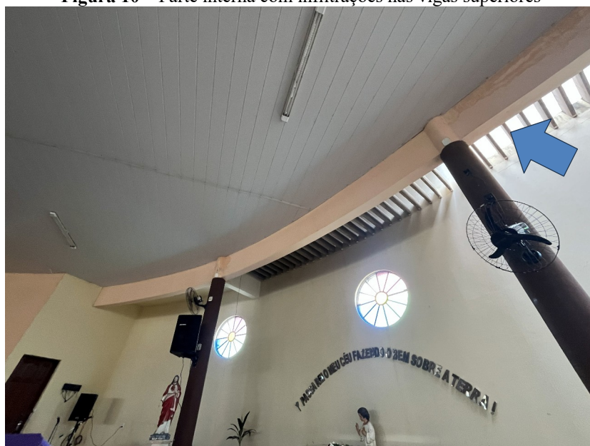
Figura 10 – Parte interna com infiltrações nas vigas superiores
