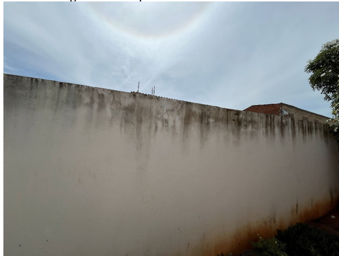
Figura 30 – Capilaridade no Muro de divisa
