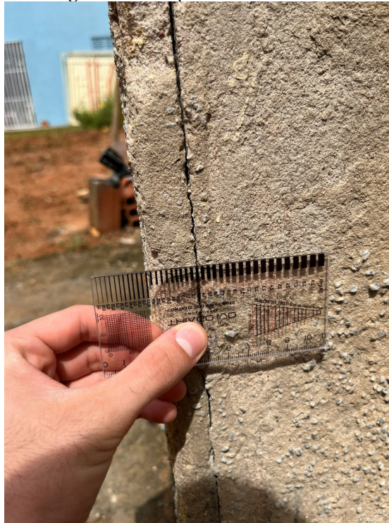
Figura 32 – Desplacamento do Reboco
