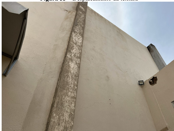
Figura 33 – Desplacamento da textura
