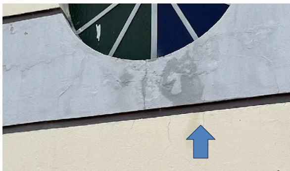
Figura 17 – Fissuração devido à possível falta de contraverga
