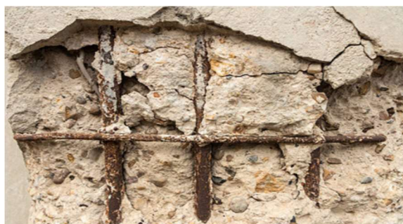
Figura 2 - Spalling em pilar de concreto
