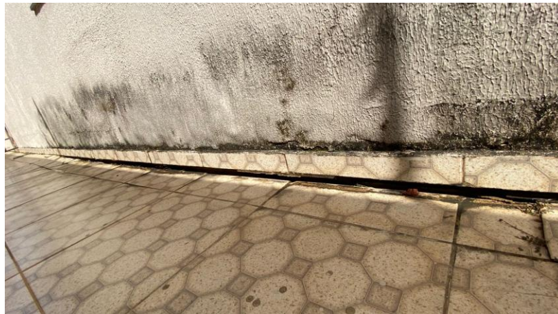
Figura 37 - Desnível devido a deslocamento vertical
