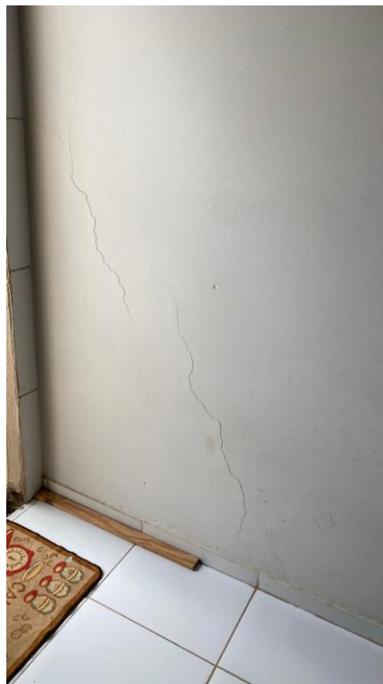
Figura 35 - Fissura em alvenaria
