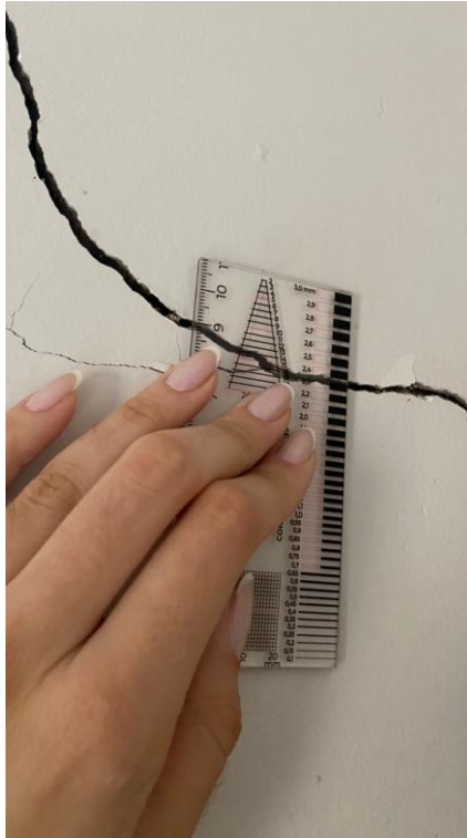
Figura 30 - Rachadura em alvenaria
