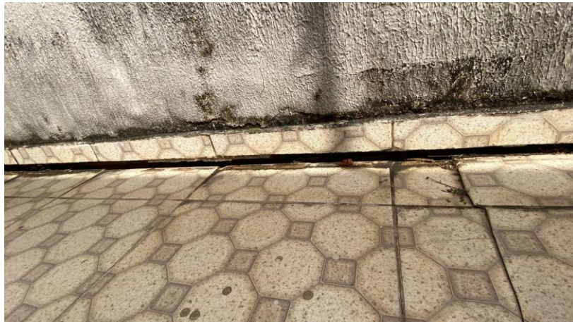
Figura 33 - Desnível devido ao deslocamento vertical
