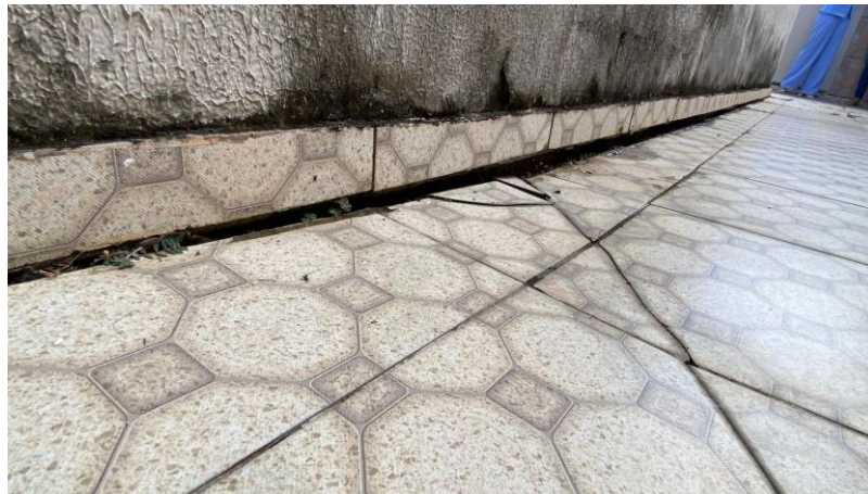
Figura 27 - Desnível devido ao deslocamento vertical
