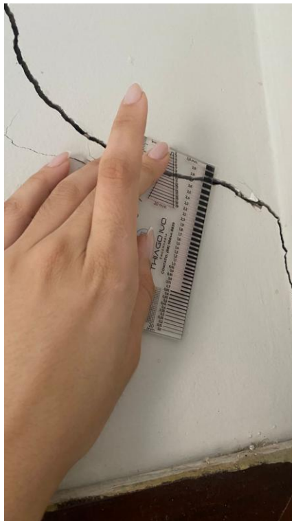
Figura 29 - Rachadura em alvenaria próximo a elemento estrutural
