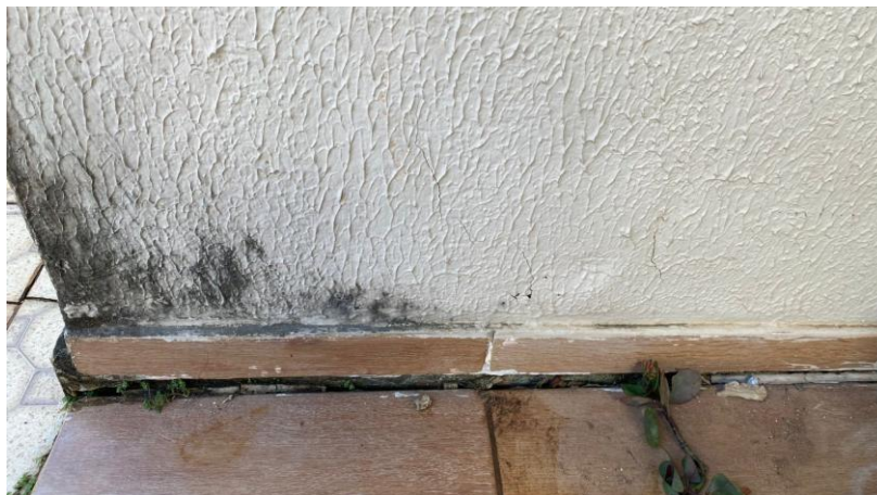
Figura 24 - Deslocamento cerâmico e desnível
