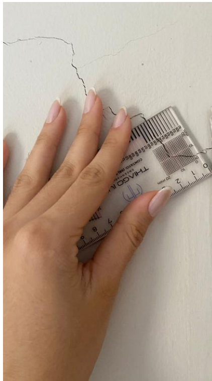
Figura 39 - Fissura em alvenaria
