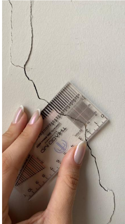
Figura 32 - Fissura em alvenaria
