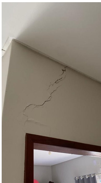
Figura 25 - Rachadura em alvenaria
