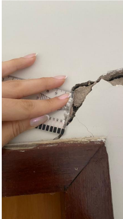
Figura 34 - Rachadura próximo a esquadria
